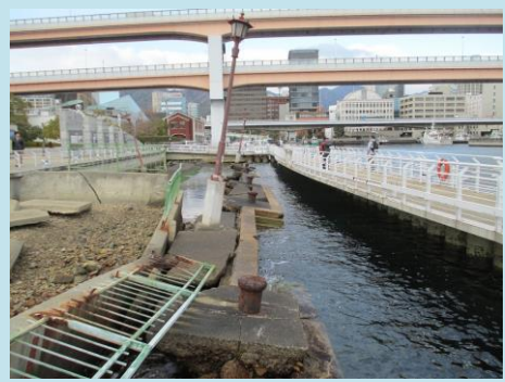
「神戸港震災メモリアルパーク」 震災当時の姿を一部遺し、被害の大きさを今に伝えています。
